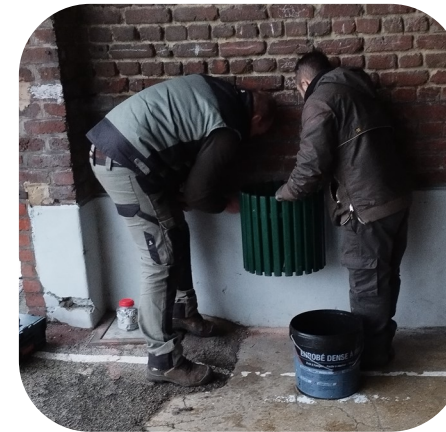
Installation de poubelles à l'école Clémence Leroy
